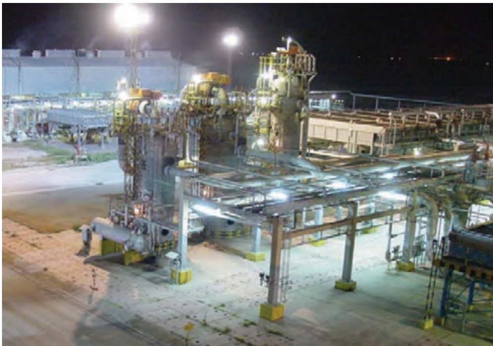
شکل ۳۲-۵- کارخانه گاز و گاز مایع شماره ۹۰۰- اهواز
